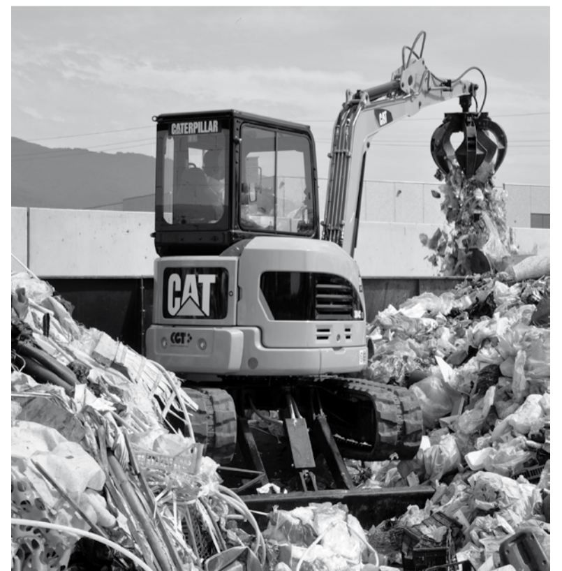
Il "ragno" sposta il multimateriale verso l'impianto
